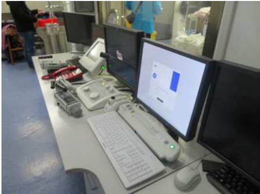
图 3-2 控制室控制台
