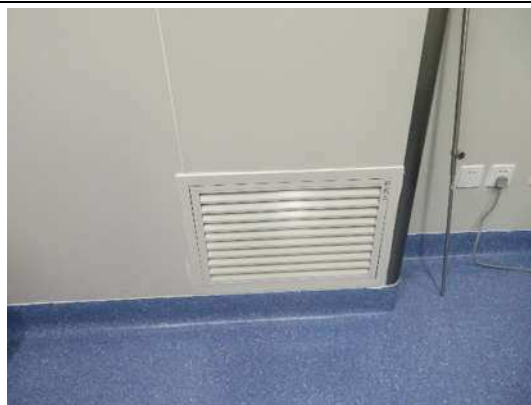
图 3-6 机房内排风口
