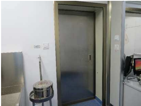
图 3-3 控制室出入机房防护门
