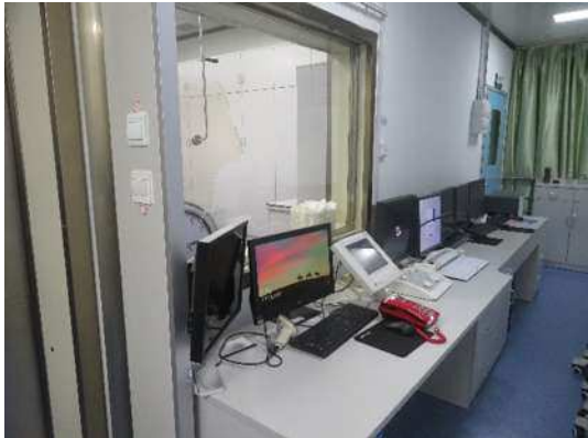
图 3-1 控制室铅玻璃观察窗
