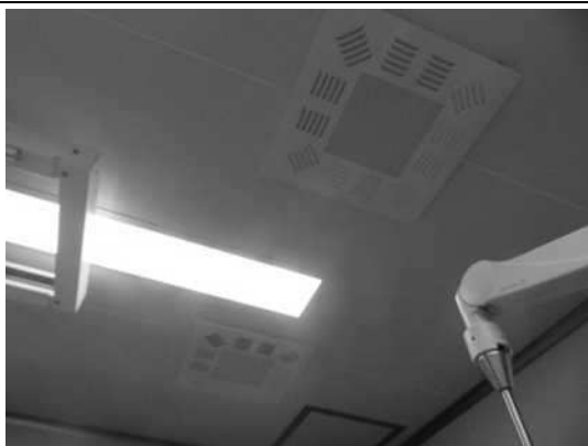
图 3-5 机房内送风口
